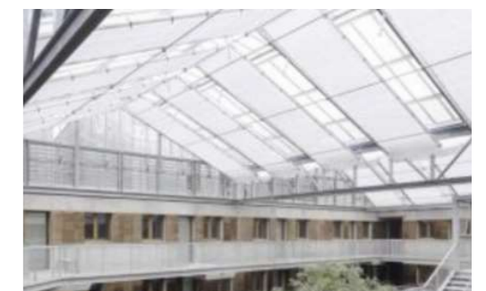
toiles tendues pilotées électriquement Edensquare/ Hauvette & Associés
