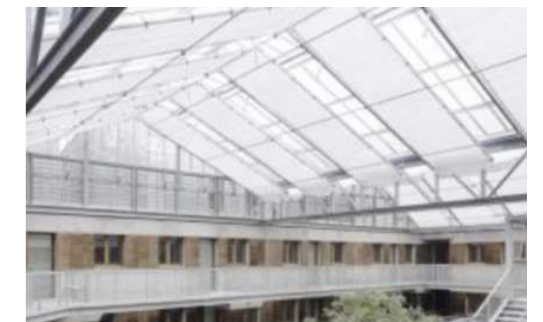
toiles tendues pilotées électriquement Edensquare/ Hauvette & Associés
