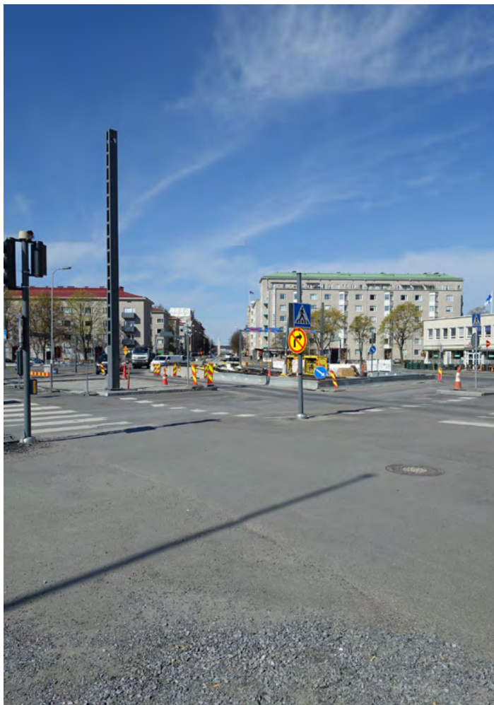
Chantier du futur tramway dans le quartier de Kaleva à Tampere Construction site of the future tramway in the Kaleva district, Tampere
